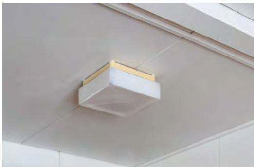
Kuva: Katoissa on 1980-luvun valaisimia ja johtokoteloita.
