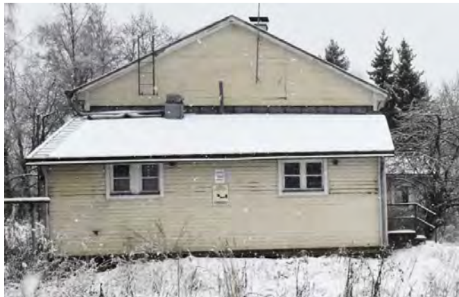
Kuva: Saunan sisäänaukeavat ikkunat ovat seinän yläreunassa. Ullakkopäätyyn on ehkä 80-luvun remontin yhteydessä jouduttu tekemään iso aukko, joka on sitten vanhoilla paneelilaudoilla naulattu umpeen.
