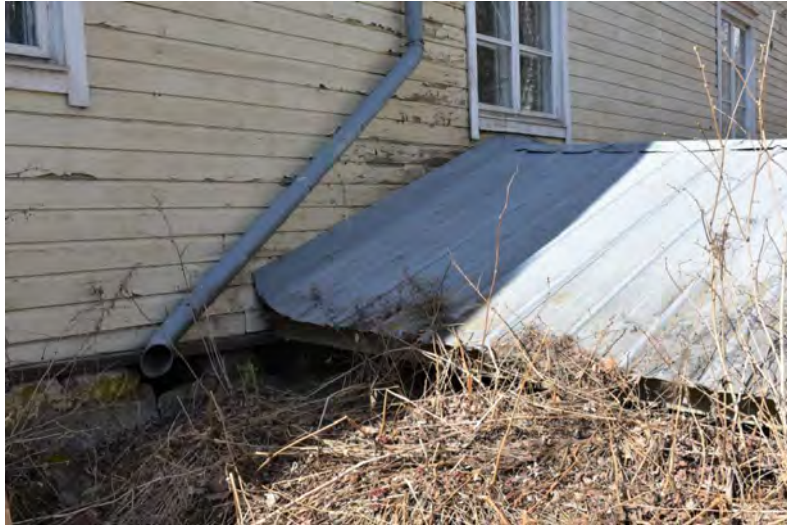
Kuva: Kellarin ja seinän liitoskohta on ongelmainen.
